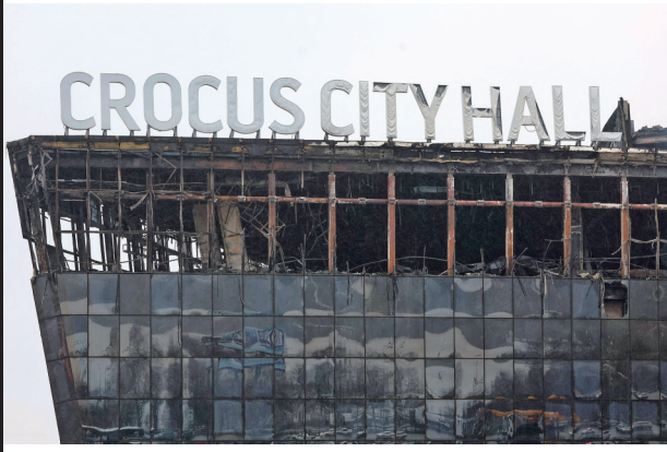
音乐厅大楼顶部被焚烧后满目疮痍
