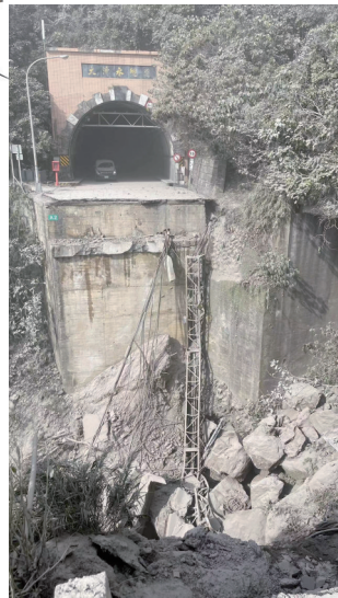
苏花公路清水隧道外发生塌方 新华社发(台湾中时新闻网供图)
