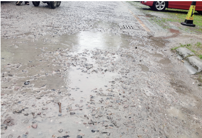
小区道路坑洼不平
