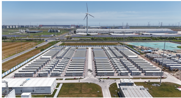
江苏丰储共享储能项目现场
