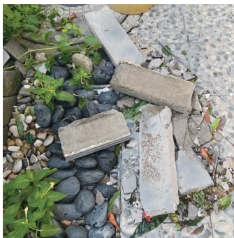
掉落下来的水泥块
