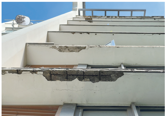
原本在水泥深处的钢筋已经裸露在外
