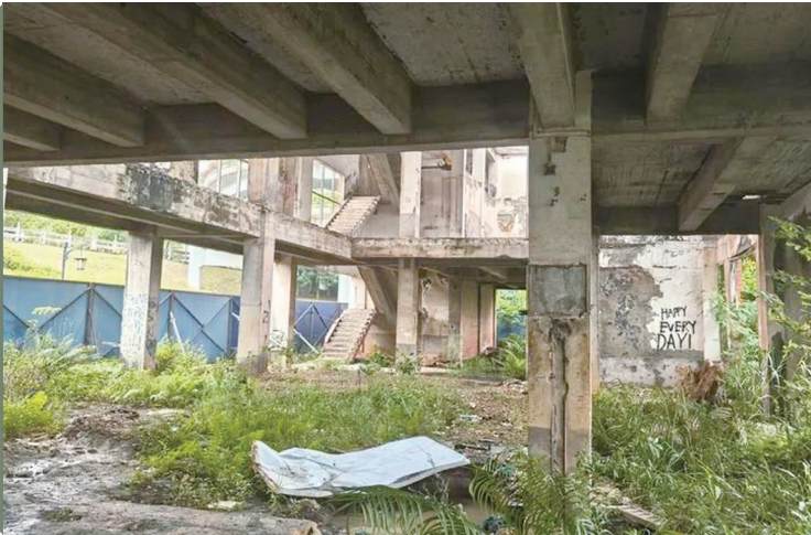
南宁市邕江畔的一处废弃建筑 新华社记者 覃星星 摄
