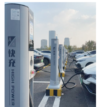
碧云路南侧停车场充电站 通讯员供图
