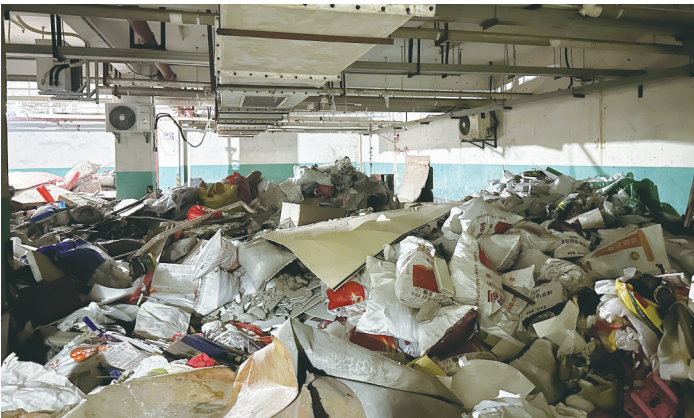
嘉阳生活广场的地下车库里垃圾堆成“小山”
