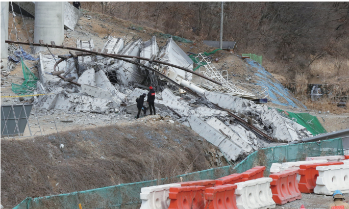
韩国在建高速桥梁坍塌现场 新华社发
