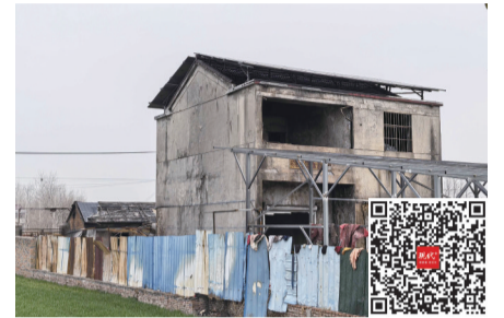
烧毁后的房子 通讯员供图(扫码看视频)
