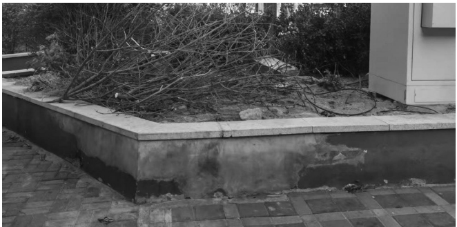
花池边白色修补部分系车辆撞击破坏所致 本组图片由曹某某家人提供
