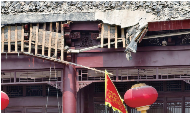
局部损坏严重
