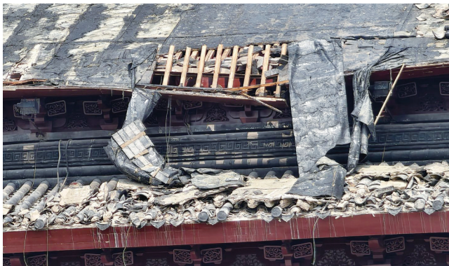
瓦片大面积脱落损毁
