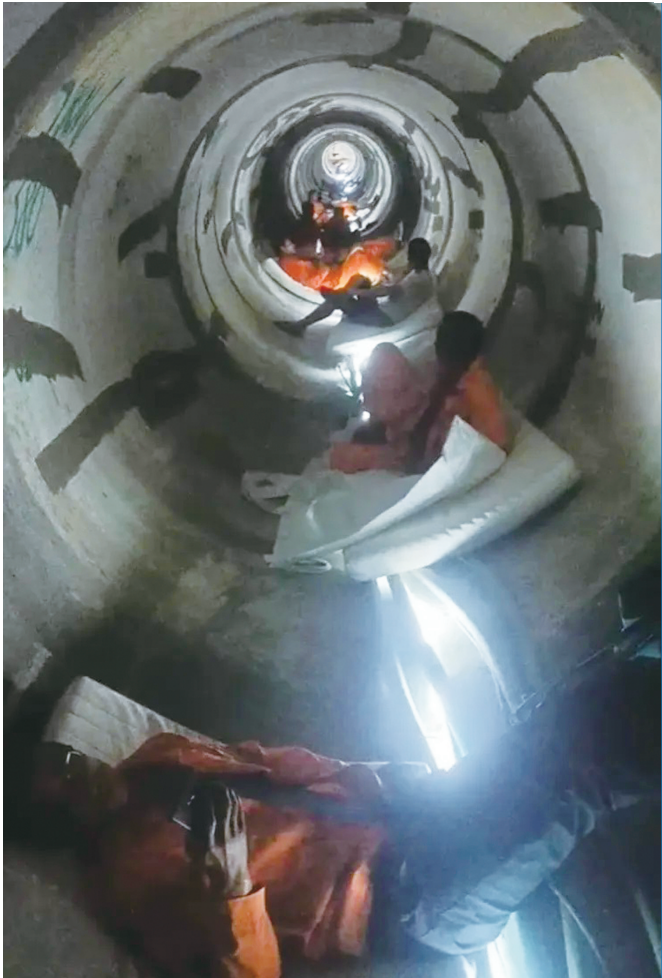
唐先生说,大家也经常修地铁的地下管道里躲避 受访者供图
